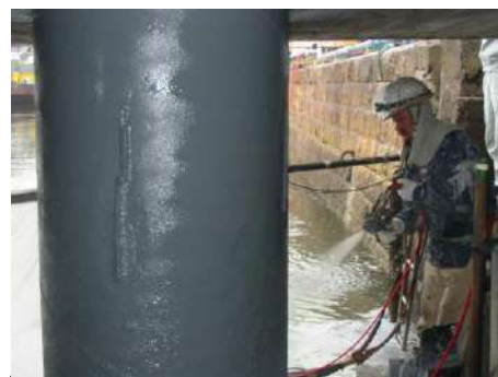
中塗材吹付け
